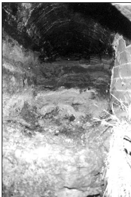
Rys. 9. Murowany przewód kanalizacji fortecznej w kolizji z tunelem metra. Fot. Z. Rekuć
